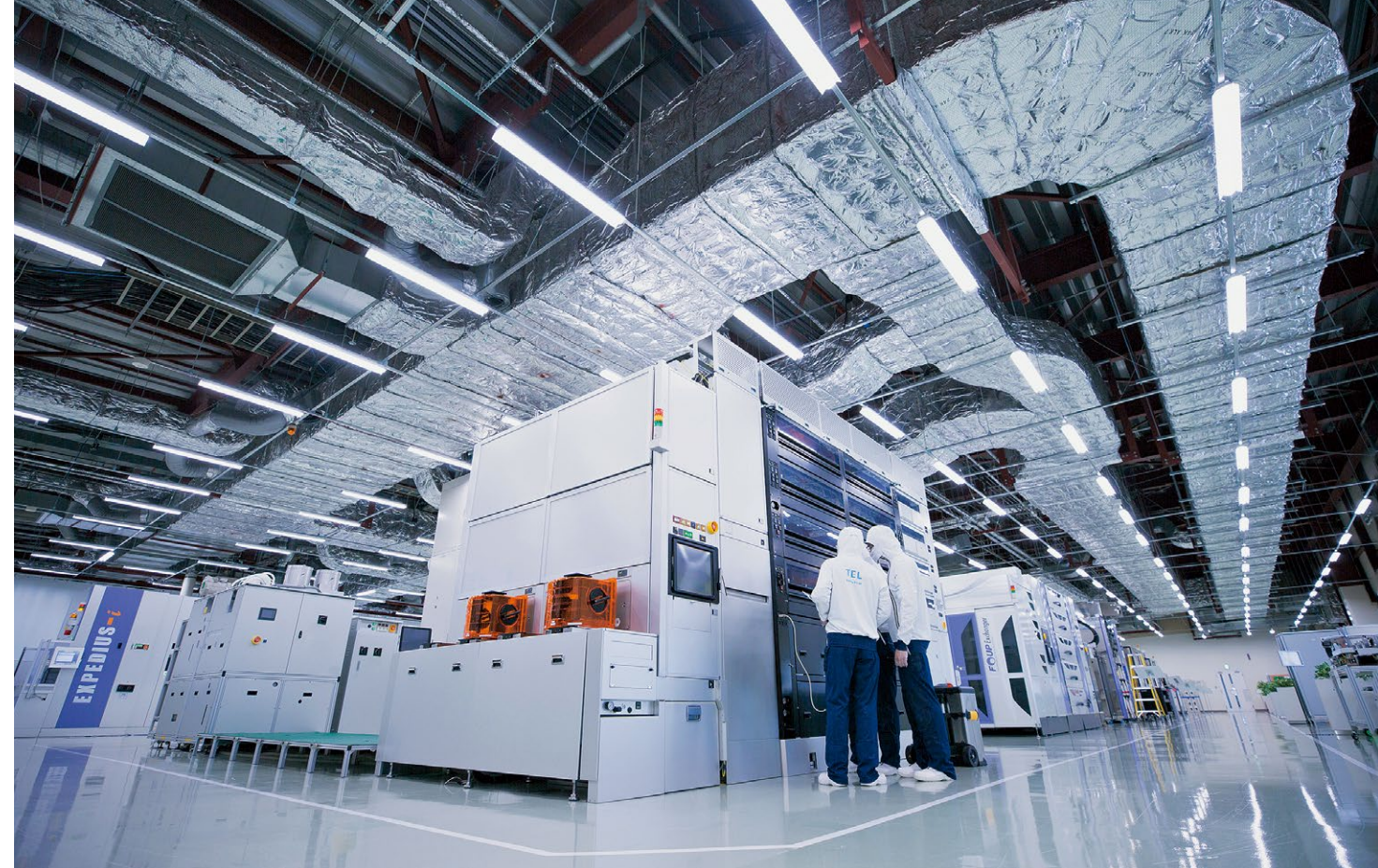
■九州群聚近200家半導體上下游設備、機台業者，成為日本重振半導體產業的重鎮，也是台積落腳的原因。圖為日本第一大科技廠東京威力科創廠房。（東京威力科創提供）
